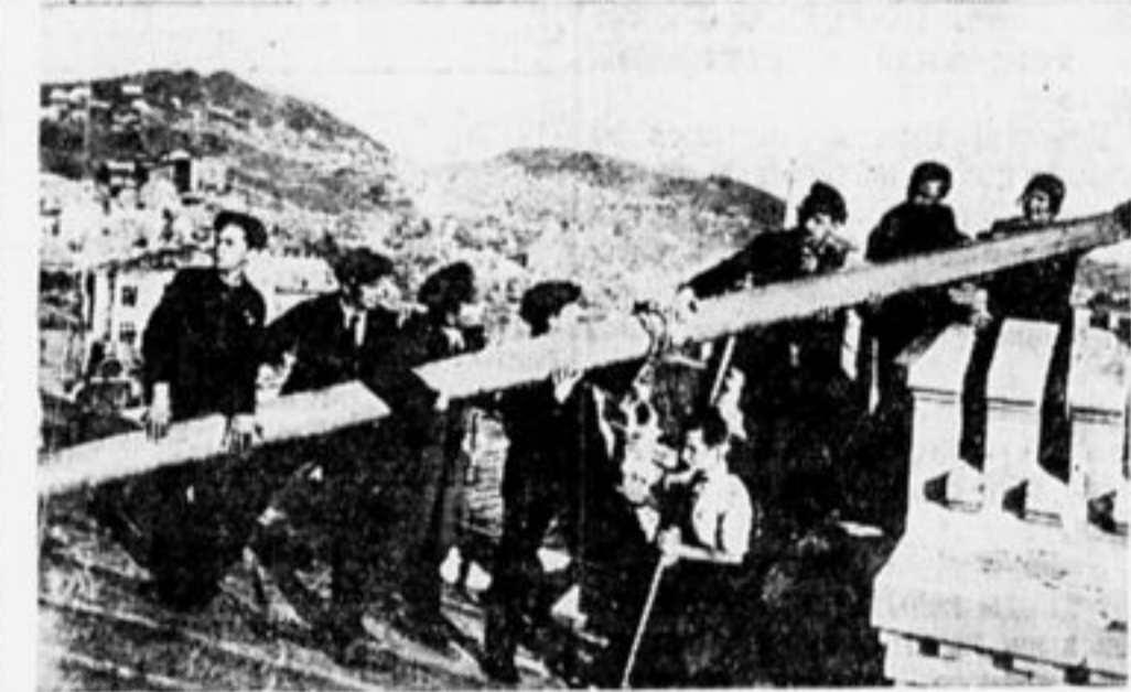
В гор. Владивостоке радиолюбители своими силами установили радиостанцию. На снимке момент установки мачты.
